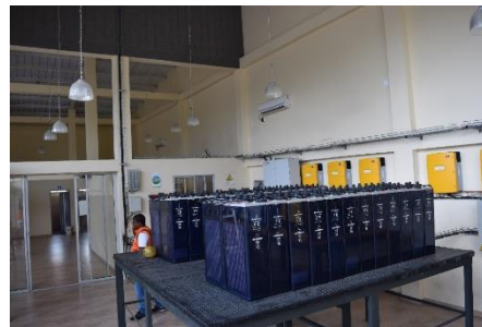
Equipos Centro de Energía renovable Andagoya
