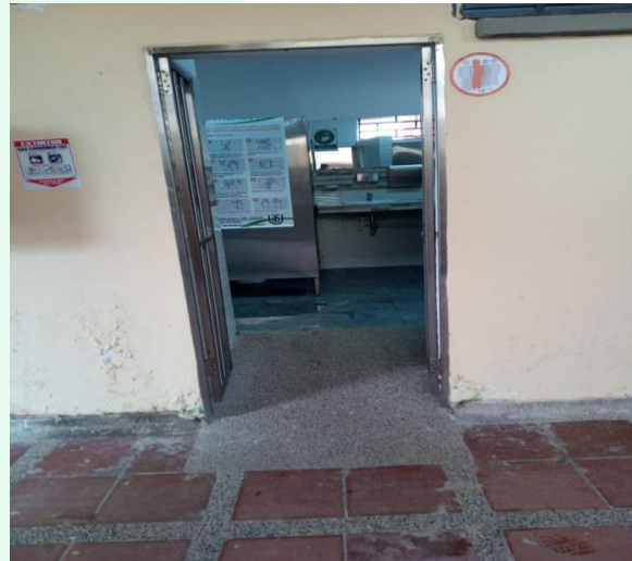
Foto: Bateria Sanitaria PMR
