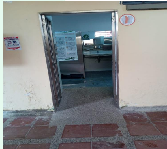
Foto: Bateria Sanitaria PMR
